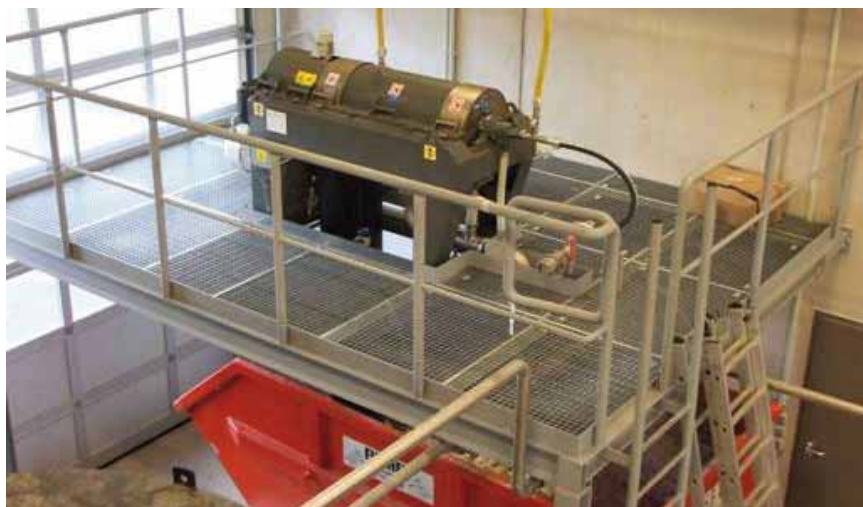
Zentrifuge zur Schlammentwässerung
